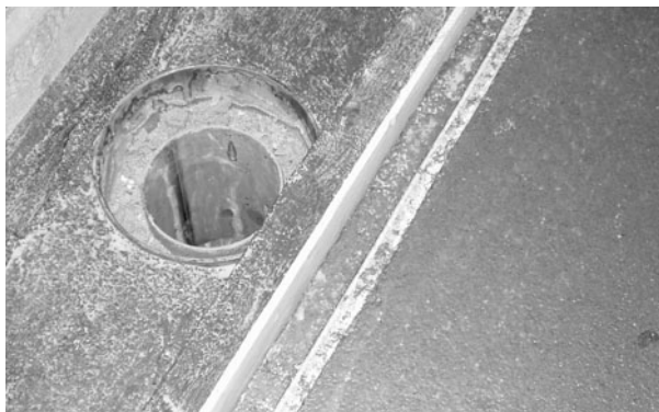
Odtokový žlab vytvarovaný v betonové vrstvě s nařezanou kotvicí drážkou a viditelným zámekem na hraně žlabu
