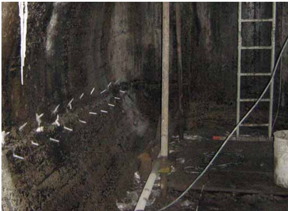
Sanace: průsaky v objektu dopravní štolý
