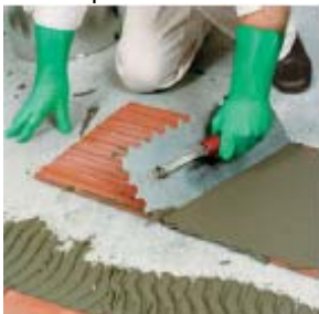
3/ Pro bezdutinové pokládání velkých obkladů se maltová vrstva nanáší i na rubovou stranu obkladů.
