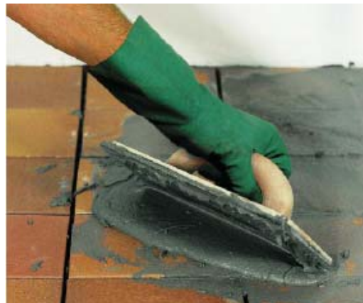
Pro spáry bez trhlin v šířkách od 5 do 20 mm.
