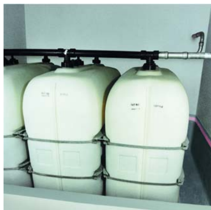
Sklad topného oleje s ochranným nátěrem PCI Visconal®.
